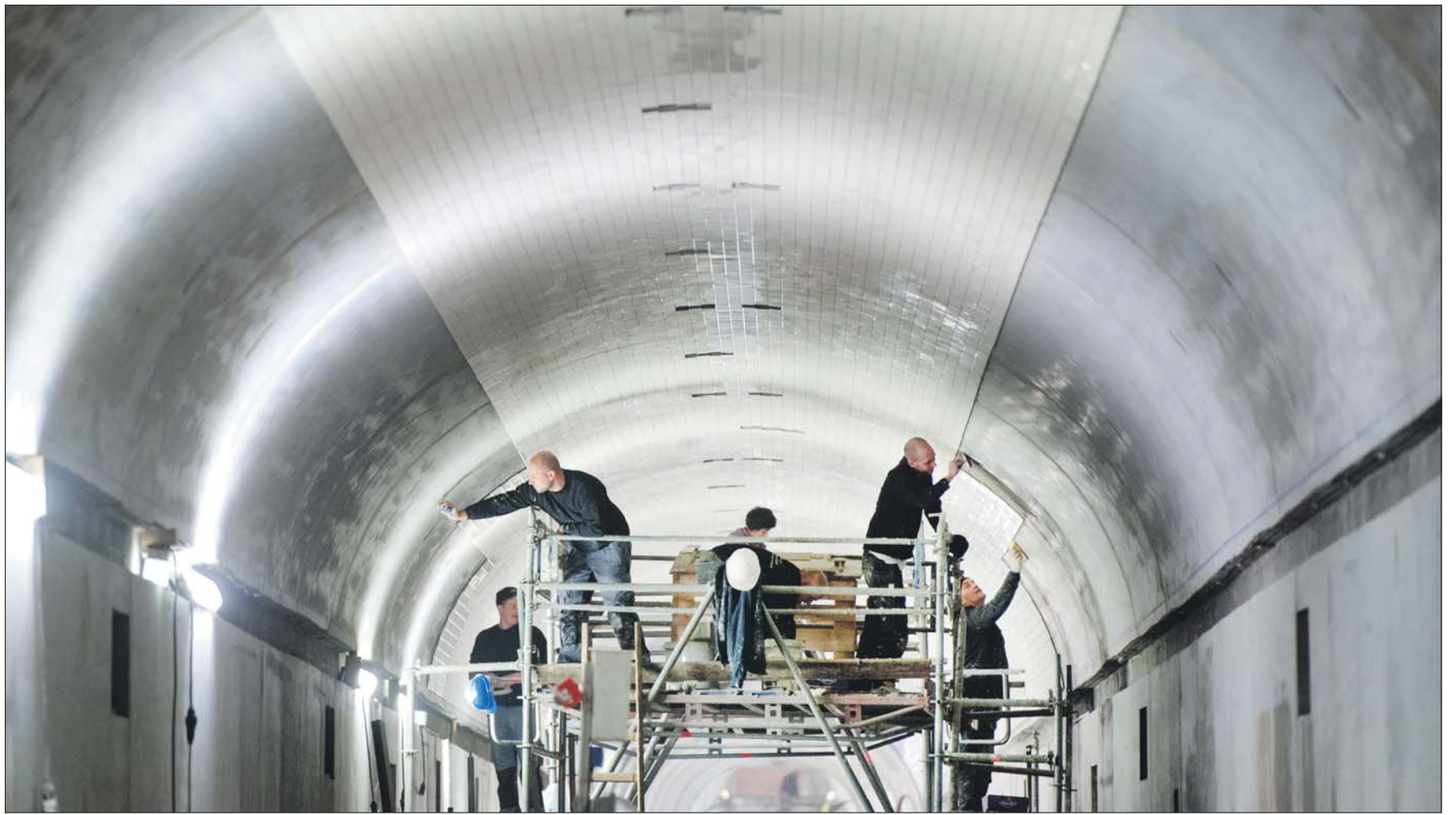
Ende April sollen die Fliesenarbeiten abgeschlossen sein, bis zu 20 Mitarbeiter der Kieler Firma Rabe sind täglich vor Ort.
